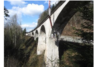
Von einer mobilen Arbeitsbühne aus werden am Laufenmühle-Viadukt bei Welzheim Zustandsaufnahmen per Radar und Ultraschall durchgeführt (Foto: KIT Innovation HUB).
