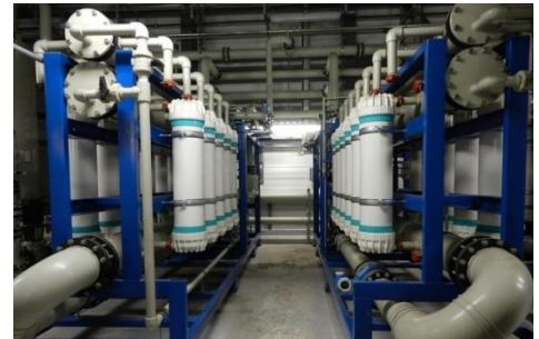
Eine Ultrafiltrationsanlage entfernt durch extrem feine Membranstränge antibiotikaresistente Bakterien aus dem Abwasser. (Foto: HyReKA)
