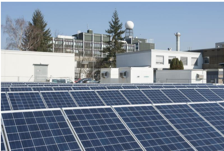
Unter anderem im Fokus des neuen Graduiertenkollegs: Photovoltaik als eine wichtige Säule der künftigen Energieversorgung. (KIT / Markus Breig)
