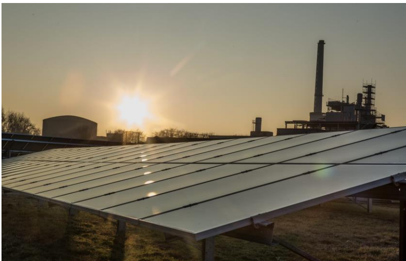
Nachhaltige Technologien wie der Solarstromspeicherpark am KIT bilden die Bausteine für die Energiewende. (Bild: KIT)
